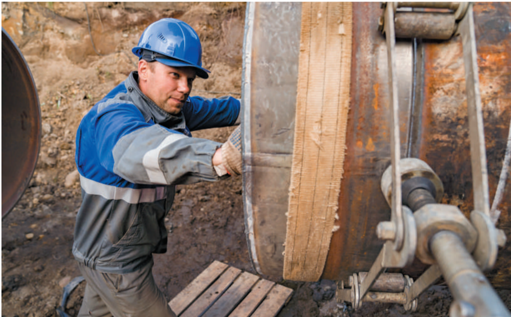
Слесарь по ремонту технологических установок 6 разряда КЦ №3 Вуктыльского ЛПУМГ Владимир Алексеевич Власкин монтирует переходное кольцо на технологический трубопровод
