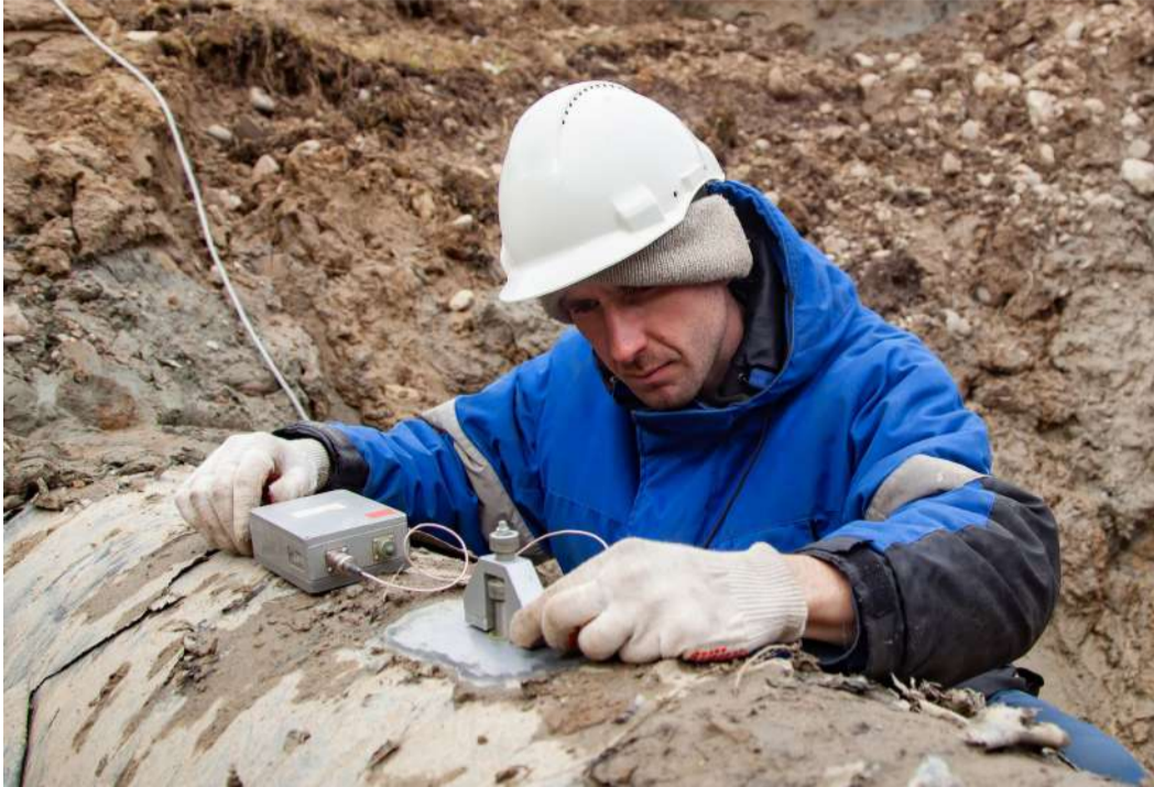
Дефектоскопист подрядной организации Андрей Алексеевич Феоктистов устанавливает магнитный акустический датчик и преобразователь сигнала на трубопровод
