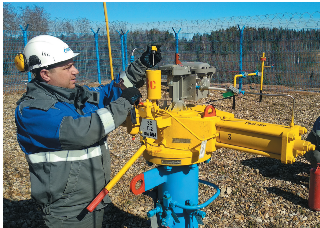
Сотрудники линейно-эксплуатационной службы-1 Нюксенского ЛПУМГ производят сезонное обслуживание трубопроводной арматуры на линейной части магистральных газопроводов. На фото – линейный трубопроводчик Иван Юрьевич Кузнецов
