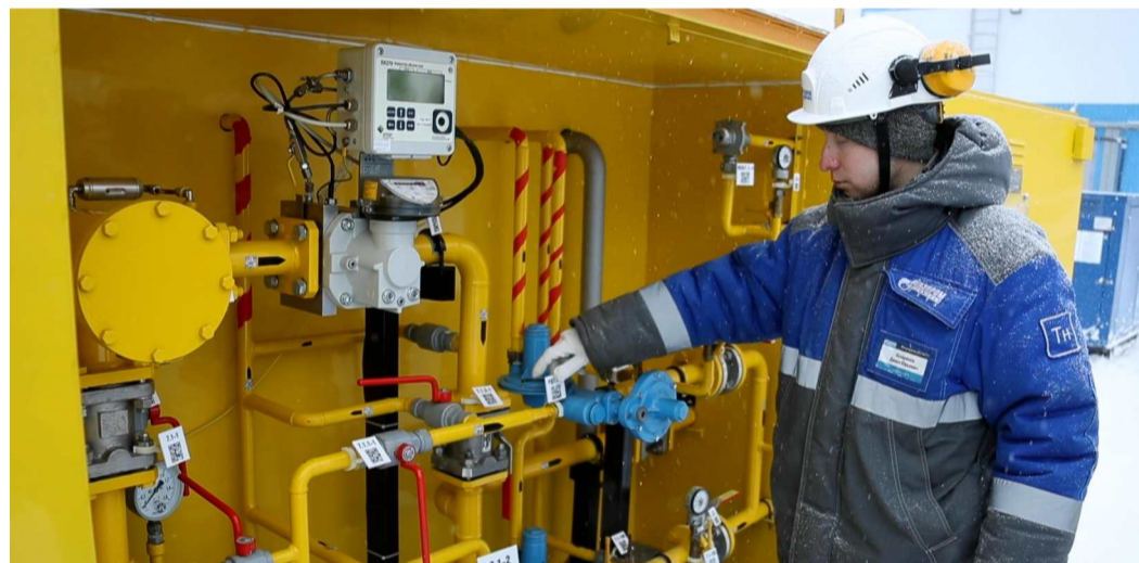
Данил Казаринов – инженер службы по эксплуатации газораспределительных станций Микуньского ЛПУМГ
