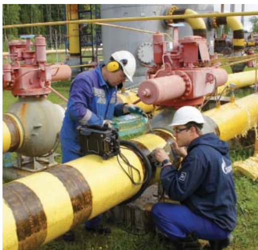
Ведущий инженер отдела ТД Я.Н. Поставлатий и инженер I категории отдела ТД С.С. Галкин проводят обследование кольцевого сварного соединения технологического трубопровода ГРС
