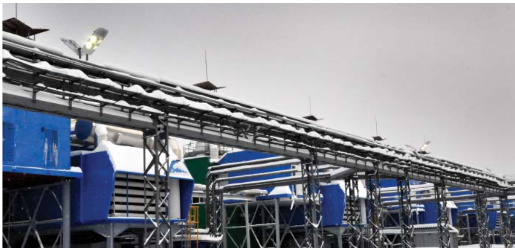
Светодиодные светильники, установленные в Микунском ЛПУМГ.
