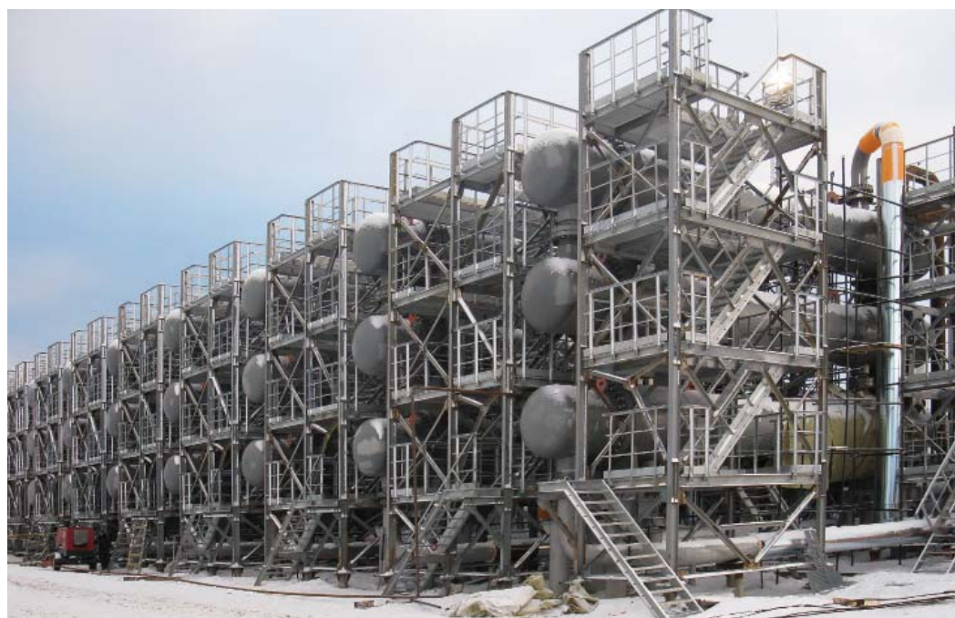
Рекуператоры охлаждения газа
