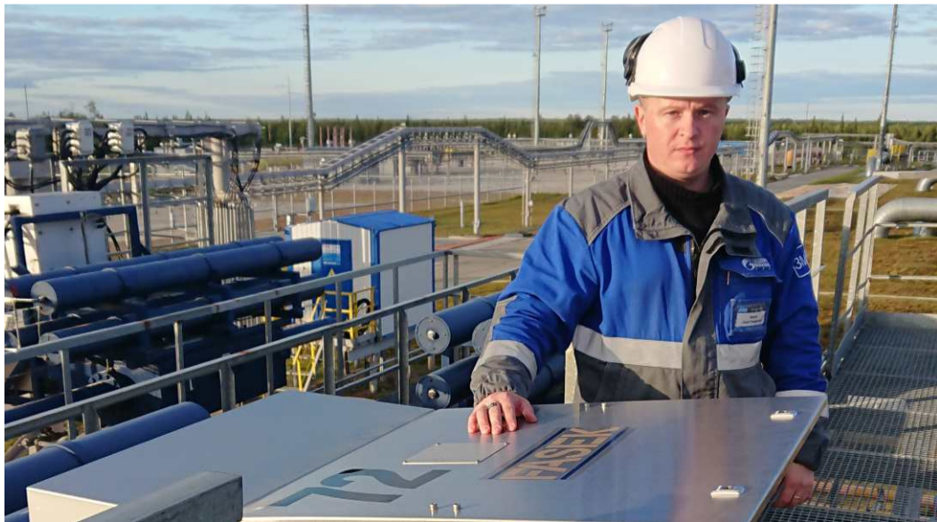
Павел Геннадьевич Иванов, начальник КС «Чикишинская», выполняет осмотр технологического оборудования
