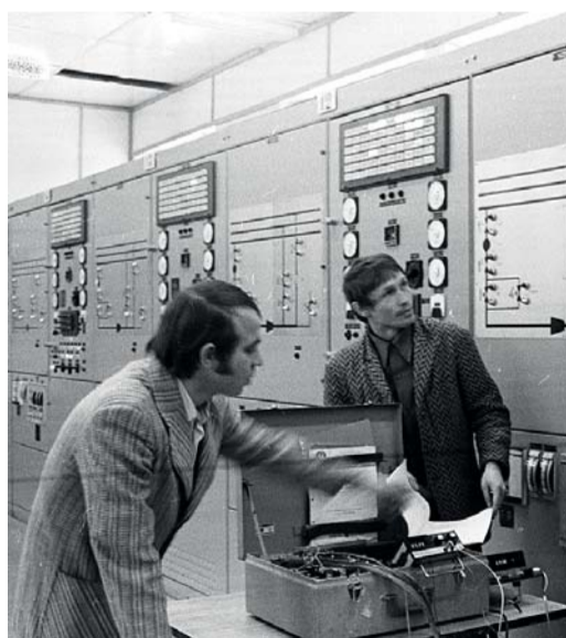
Главный щит управления филиала, 1977 год
