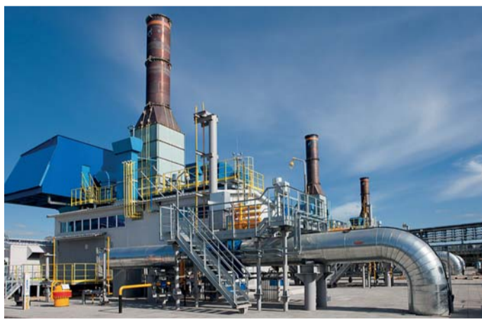
Газоперекачивающий агрегат ПА-16М-11 «Урал», КС «Синдорская»
