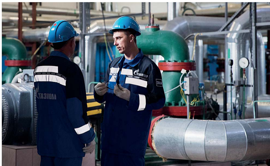
Работники филиала в котельной тепловодоснабжения
