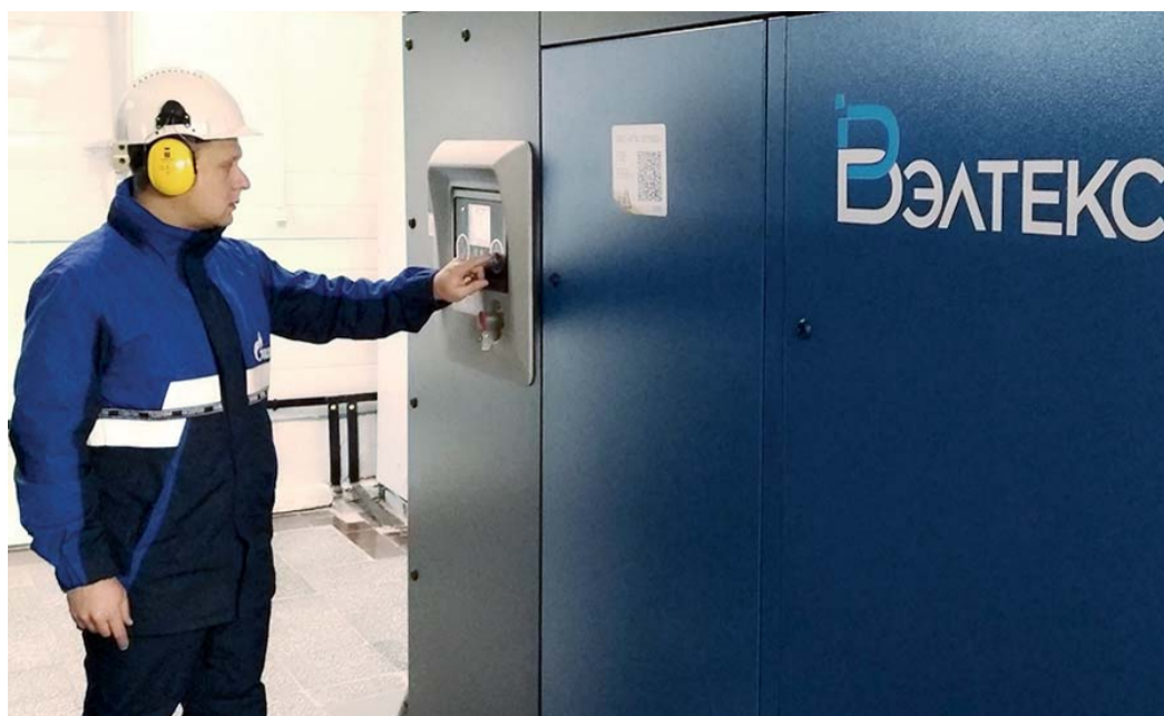
Инженер Юбилейного ЛПУМГ Андрей Гурьянов производит контроль параметров компрессора ВКМР-110 БМ «ВЭЛТЕКС»
