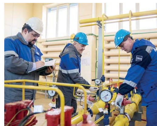
Работники на газораспределительной станции Приводинского ЛПУМГ
