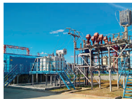
Вид открытого распределительного устройства
