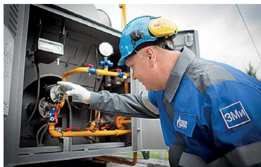
Настройка работы подогревателя газа
