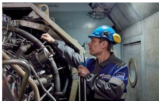
Осмотр турбины газоперекачивающего агрегата
