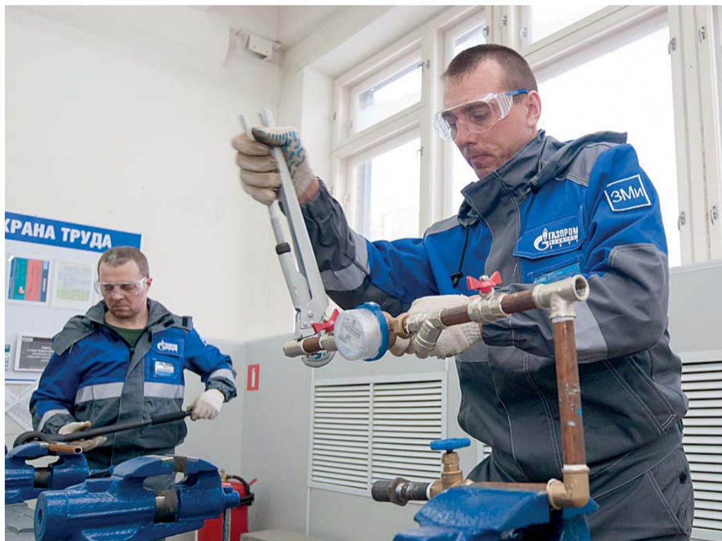
Олег Гашков из Юбилейного ЛПУМГ выполняет сборку водомерного узла на базе УПЦ
