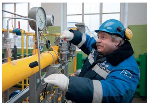
Оператор ГРС 5 разряда Анатолий Мангаев выполняет корректировку выходного давления регуляторов давления газа
