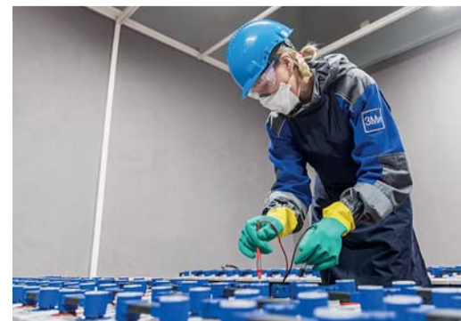
Аккумуляторщик Юлия Перегудова проводит текущий осмотр аккумуляторной батареи
