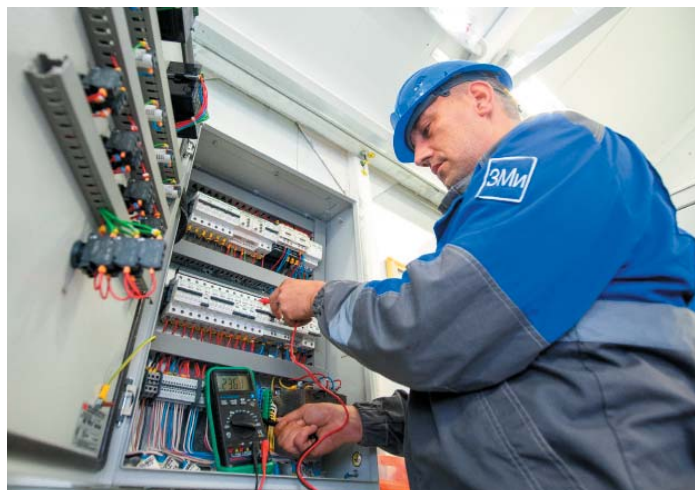
Монтер ЭХЗ Радий Сорокин проводит проверку работоспособности оборудования
