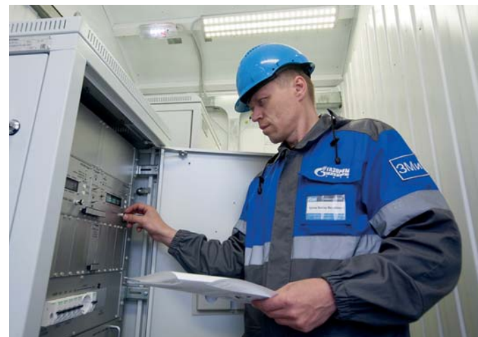
Электромонтер Виктор Кулиш проводит техническое обслуживание установки катодной защиты
