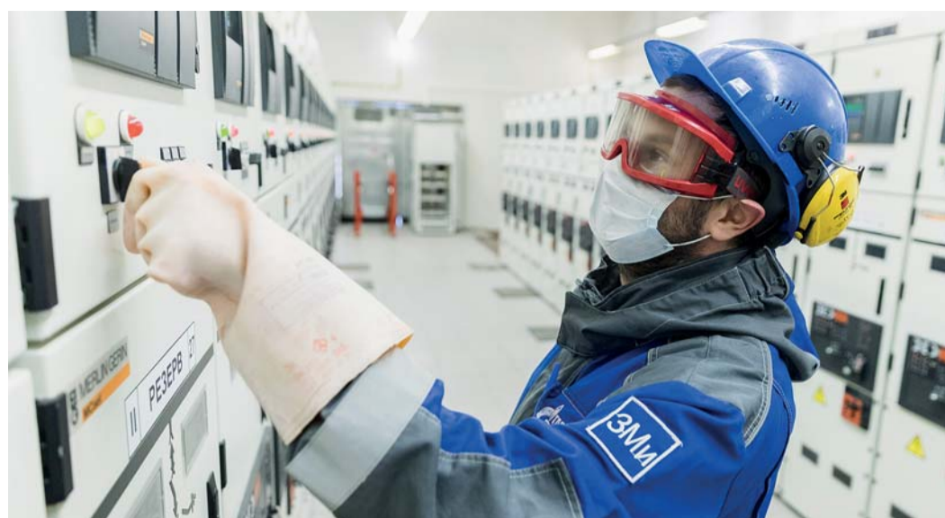
Егор Рейтман, электромонтер по ремонту и обслуживанию электрооборудования службы энергоснабжения, выполняет оперативные переключения в электроустановке ЦРП-10кВ
