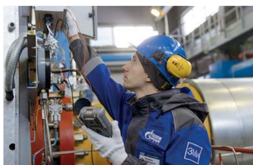
Проверка исправности цепи управления
