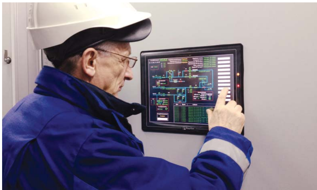
Проверка алгоритмов управления и защиты ГРС «Исток-1». В.А. Мельников – зам. начальника отдела АСУ и ТМ ИТЦ.
