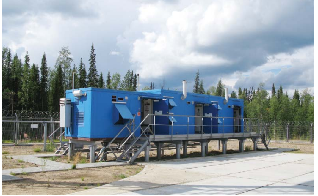
Блочно-контейнерная электростанция (БКЭС)
