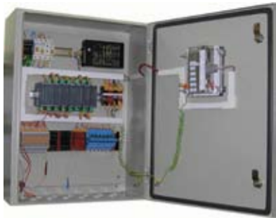
Внешний вид щита САУ ГРС
