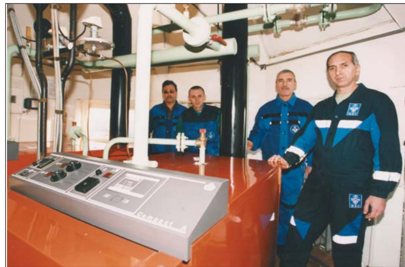
Крышная котельная в жилом доме
