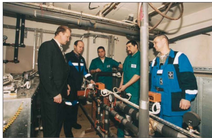
Регулировка системы вентиляции в профилактории
