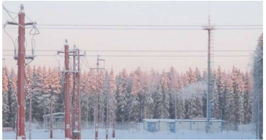
Подводящая высоковольтная линия к ГРС-2 Архангельск
