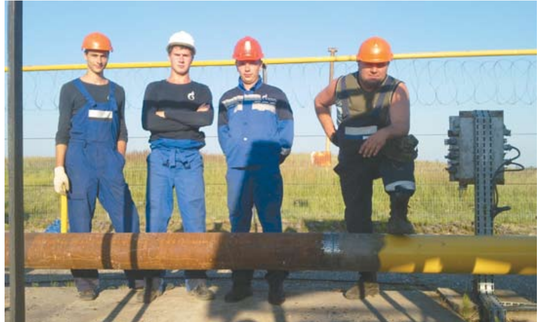
ГРС Ленинский путь. Бригада работников службы ЭГРС во главе с инженером А.В. Ворониным
