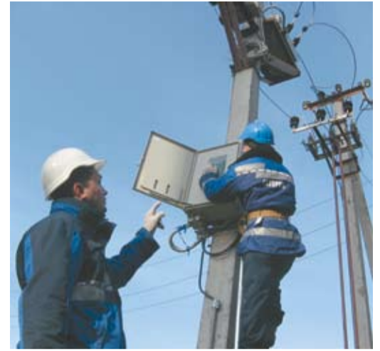
Электромонтер И.А.Терехов под руководством инженера службы ЭХЗ Д.Н.Рябцева выполняет проверку установок РЗА на автоматическом пункте секционирования АПС № 5 вдольтрассовой ВЛЗ-10 кВ «Нюксеница - Макаровская»
