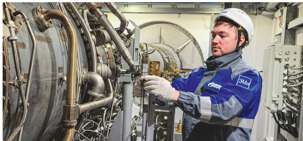
Инженер по ремонту цеха № 4 газокомпрессорной службы Юбилейного ЛПУМГ Владимир Николаевич Фуников выполняет обход-осмотр оборудования
