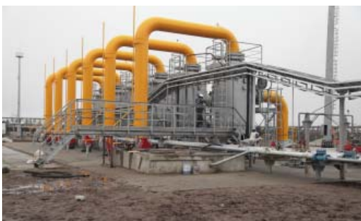
Установка очистки газа.
