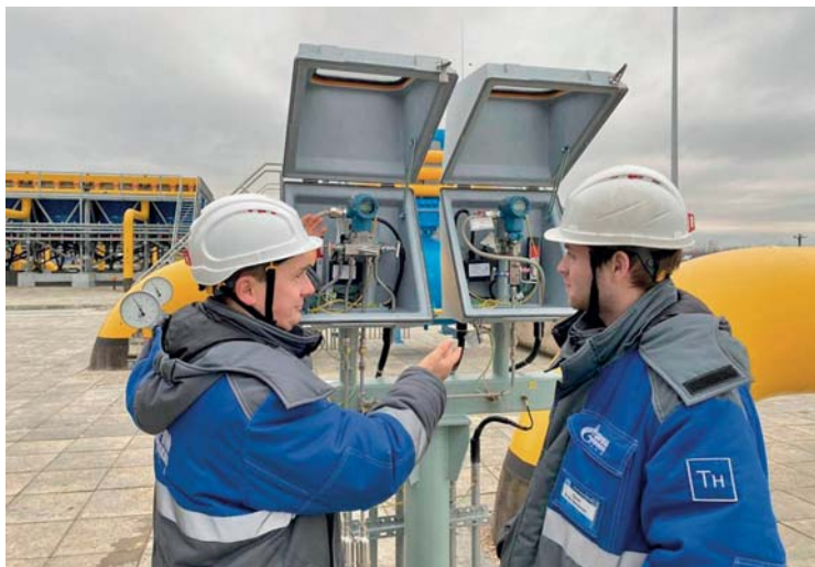
Осмотр взрывозащищённого оборудования. На фото — сотрудники службы автоматизированных систем управления, автоматики и телемеханики Сосногорского ЛПУМГ Андрей Анатольевич Мастоков и Алексей Николаевич Чеботарёв
