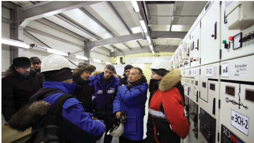
В помещении ЗРУ
